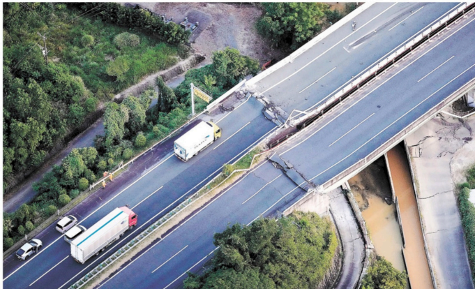
地震の影響で損傷した九州自動車道＝28日午後7時11分、八代市（共同通信社ヘリから）
