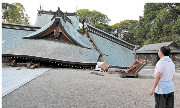
地震で拝殿が崩壊した八代宮＝28日午後6時40分ごろ、八代市（水田智）
