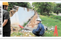
「寺跡」を視察し、崩落した築地塀の屋根の様子を確認する大西一史熊本市長 11月5日、熊本市中区
