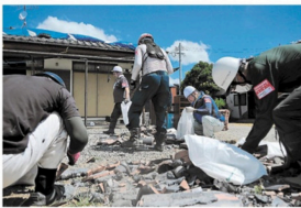
被災家屋の屋根から落ちた瓦を土のう袋に集める 災害ボランティア＝6日、宇城市
