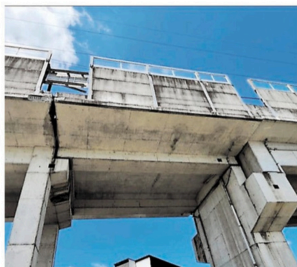
防音壁が落下し、一部が損傷した九州新幹線の熊本—新八代間の高架橋＝7月29日（JR九州提供）
