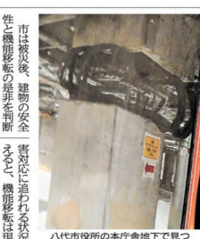
免震装置のダンパーのずれ＝7月29日、同市
