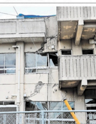
震度6強の揺れで、1階から2階にかけて縦に亀裂が入った龍峯小の校舎＝8日、八代市
