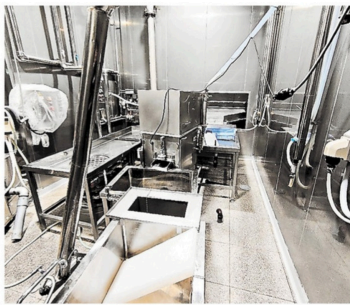
2026年熊本地震で損壊した千興ファームの食肉処理室の設備(同社提供)
