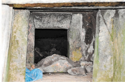
石垣の石が一部落下した野津古墳群 7月9日、氷川町(石本悠)
