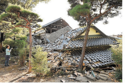
主屋の一部が倒壊した米家住宅＝7月31日、八代市(後藤仁子)
