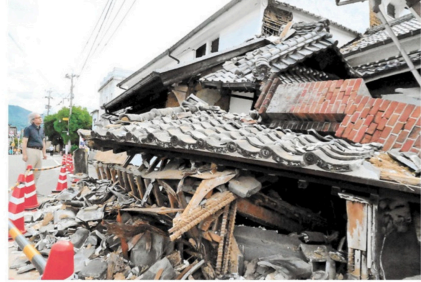
「氷川町まちづくり酒屋」は主屋の柱が損傷して傾き、門や塀は倒壊した＝8月17日、氷川町
