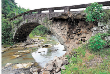
壁石崩れた石橋 7月4日、宇城市(大前尚徳)
