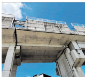
訪官壁が落下し、一部が損傷した九州新幹線の熊本 —新八代間の高架橋＝7月29日（JR九州提供）
