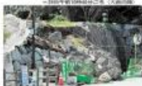
熊本城 石垣40カ所被害 八代、人古城跡でも崩落
